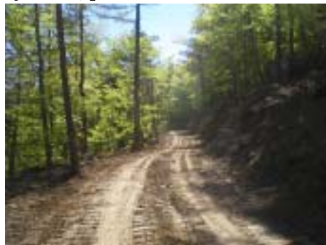
Réaménagement de la piste. La qualité du travail des entreprises a été unanimement reconnue (AMCV (Lesbros) de la Bâtie Neuve et entreprise Chabaud).
